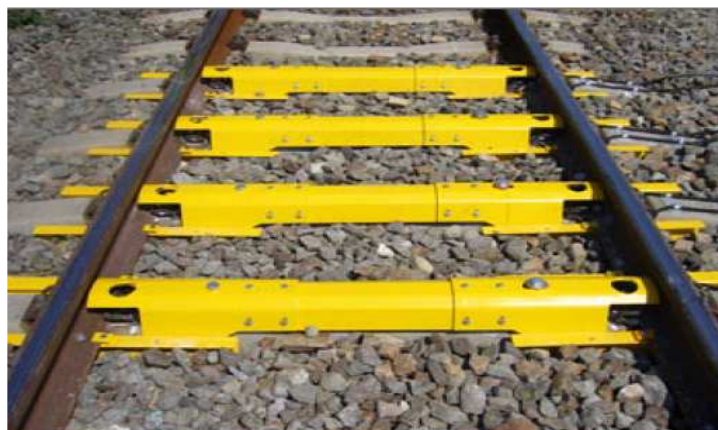
Figure 7 – Système de 4 capteurs fixés sur le traverses
