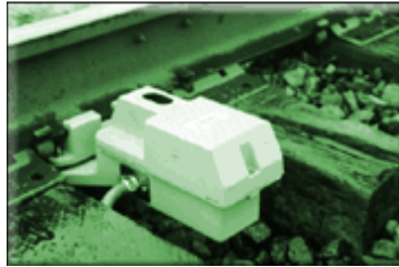
Figura 21 - Sistema di fissaggio dei DBC alla rotaia mediante morsetto.
