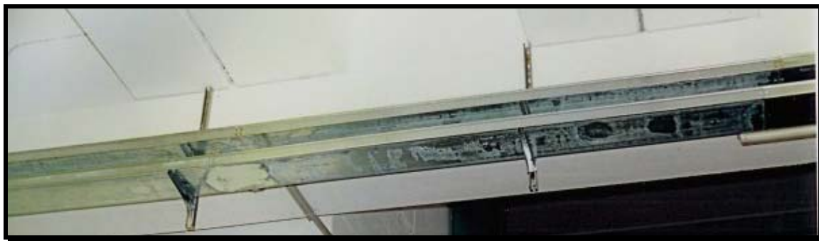
Particolare canaline metalliche.
