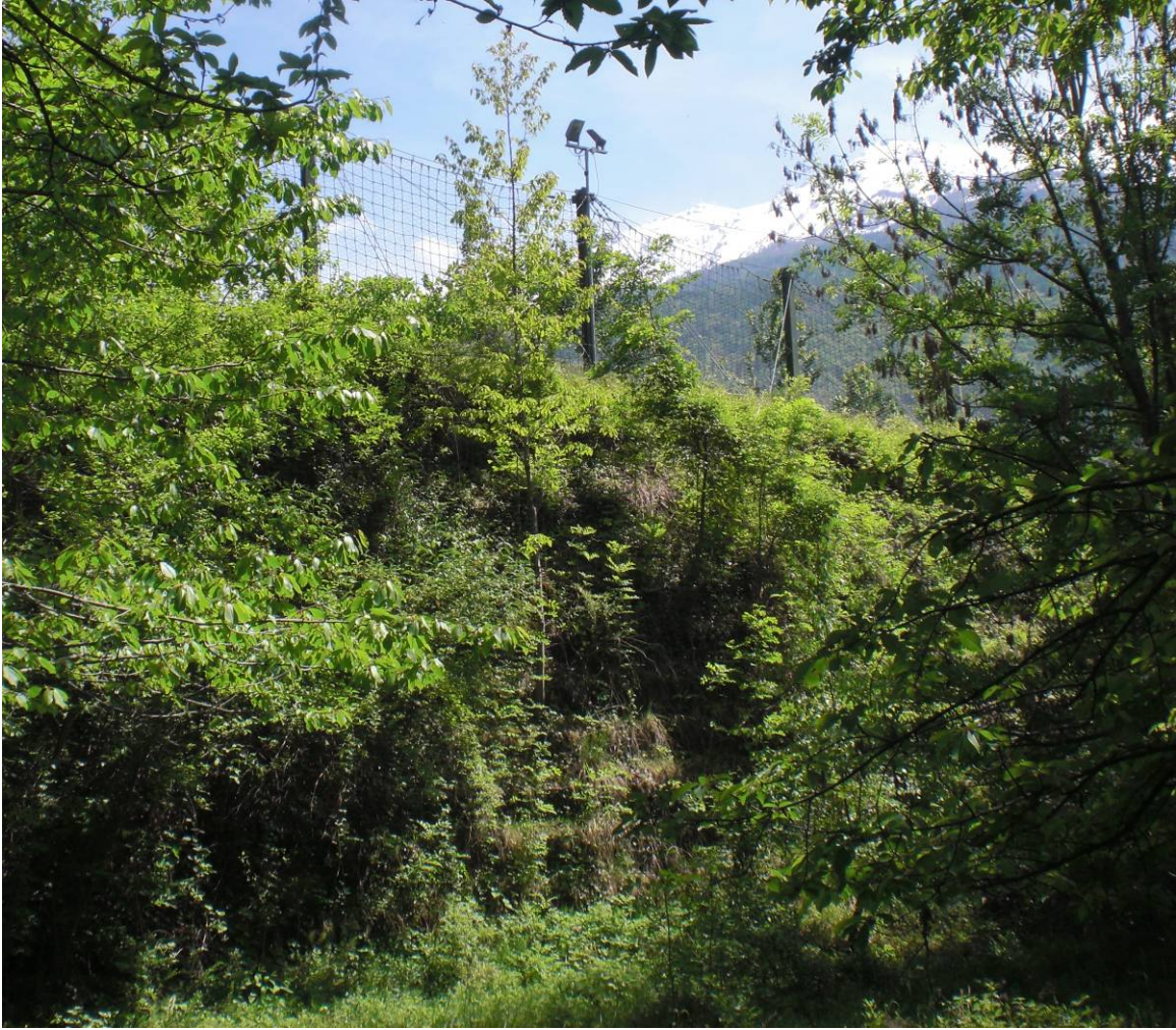
Fig. 13 – Dettaglio del rilevato paramassi e delle barriere in reti presenti a monte dell'imbocco della galleria Ramats.
