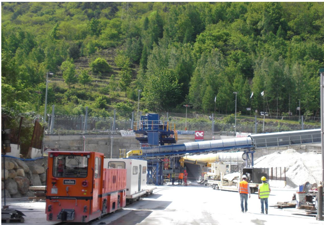
Fig. 14 – Barriere in reti paramassi presenti a monte dell'imbocco della galleria del cunicolo della Maddalena.
