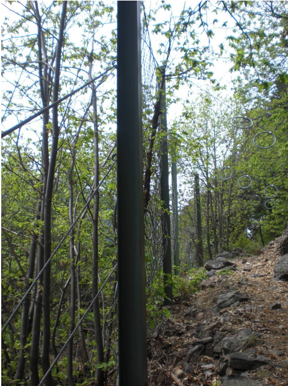
Fig. 12 – Dettaglio delle barriere paramassi presenti lungo il versante
